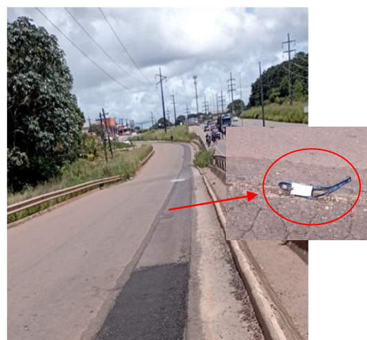
14 de Abril – Depressões no asfalto em recuperação pela empresa que realiza instalação.
